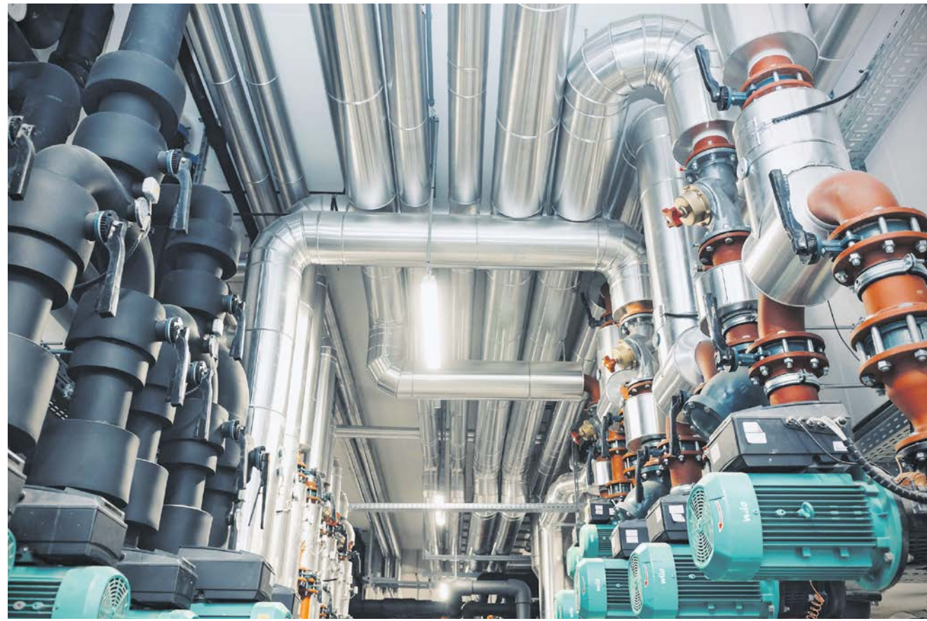
Aus allen Rohren. Unterirdische Lebensadern versorgen das Baufeld Mitte in der Smart City mit klimafreundlicher Energie.
